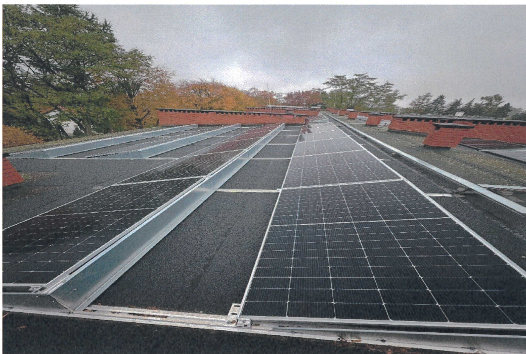
Instalacja fotowoltaiczna na dachu Szkoły Podstawowej nr 5.
