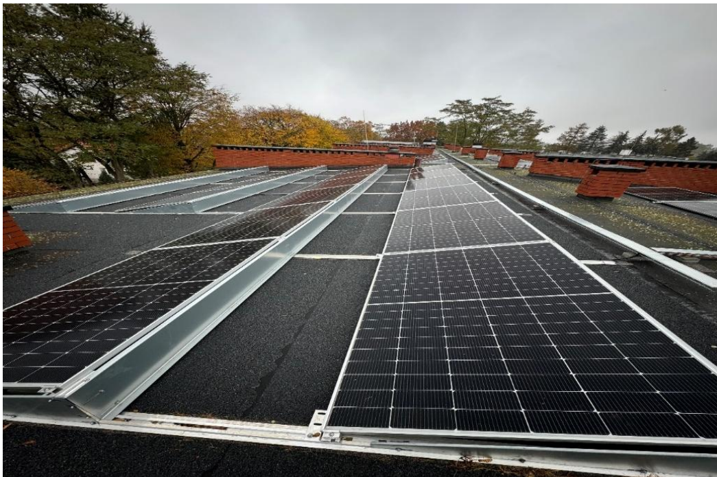
Instalacja fotowoltaiczna na dachu Szkoły Podstawowej nr 5.
