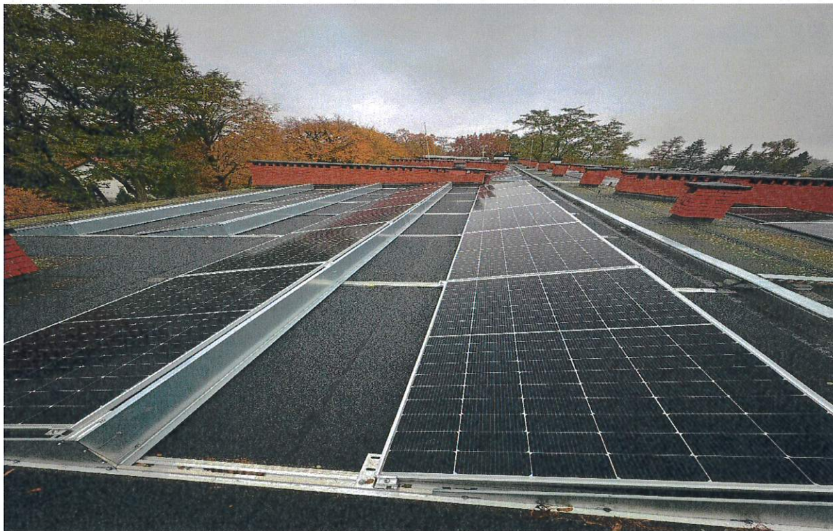
Instalacja fotowoltaiczna na dachu Szkoły Podstawowej nr 5.
